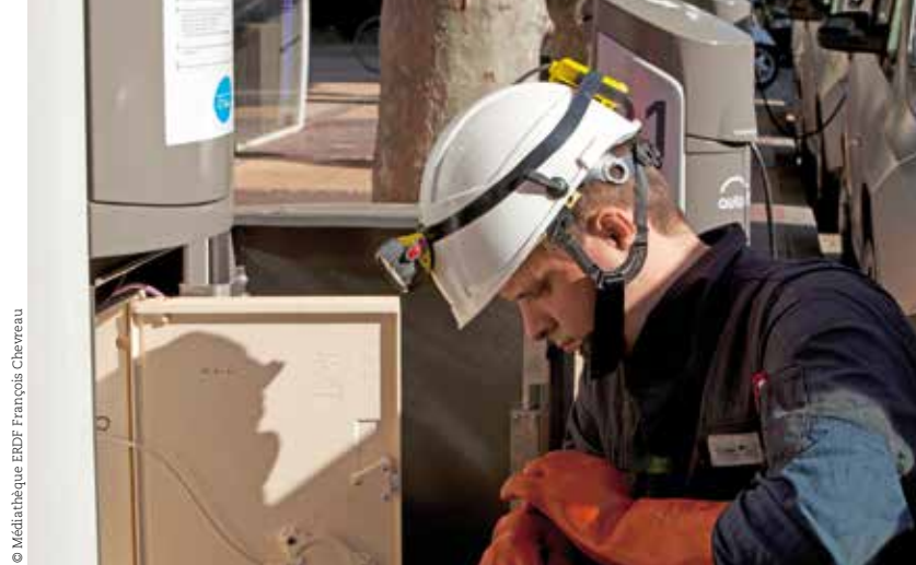
© Médiathèque ERDF François Chevreau C'est ERDF qui installe les bornes électriques permettant le branchement des Autolib' à Paris.
